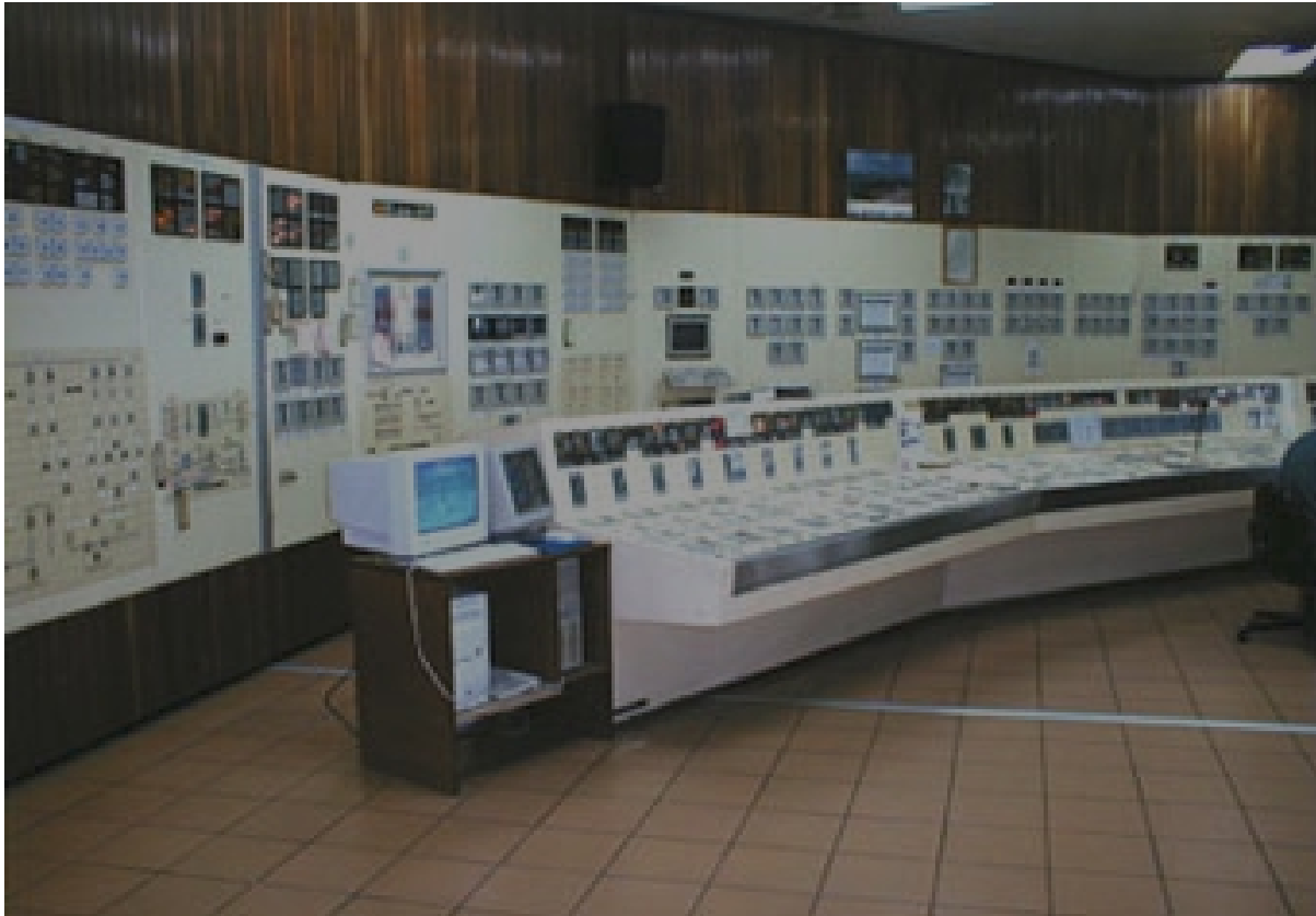
Εικόνα 2.4β. Αποψη χώρου (Control-room), όπου είναι εγκατεστημένος ο System Server.
